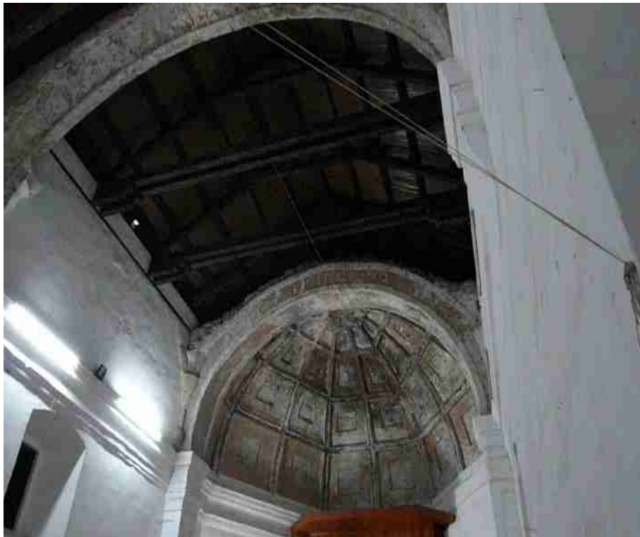
Figura 102: La cubierta de la iglesia de Chapultenango, Chiapas, México, tuvo que ser reconstruida tras colapsar por el peso de la ceniza en la erupción de 1982 del volcán Chichón (Foto J.M. Marrero, 2009).
