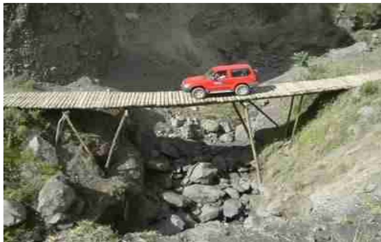
Figura 44: Vulnerabilidad por flujos. En este caso, un lahar ha cortado la carretera y se ha construido un puente provisional. Volcán Tungurahua, Ecuador 2003 (Foto R. Ortiz)
